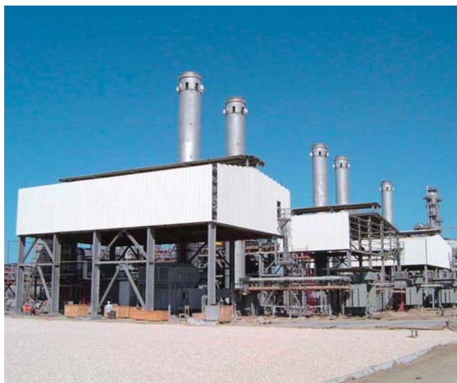
H-25 gas turbine generator sets for Egypt Damietta LNG Project
