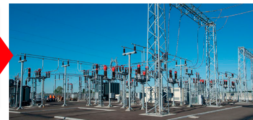
鉄道用変電所
