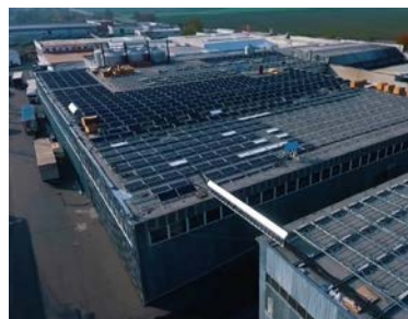
北米 送発電設備 (イメージ)
