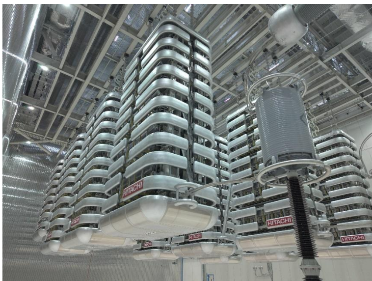
HVDC 交直変換所のバルブホール (インド・ムンバイ)
