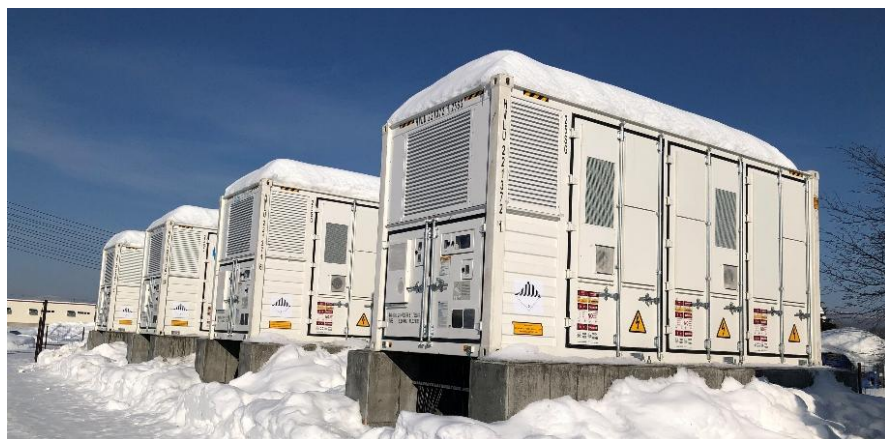
名寄 1 蓄電所の外観
