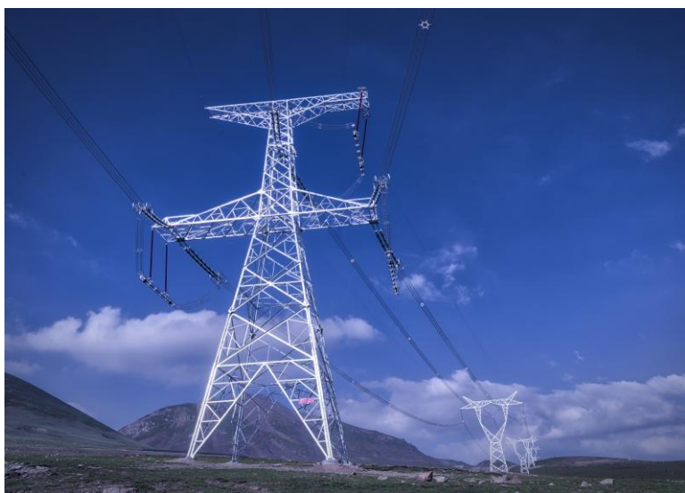
フランスのエネルギー転換を支える送電網インフラ(イメージ) 写真提供：日立エナジー
