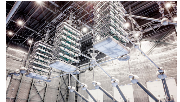
HVDC(高圧直流送電)設備
